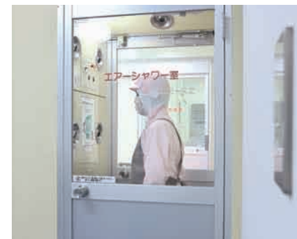
エアシャワー室
